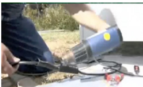
Unbedingt auf Dichtheit ach- ten, damit keine Feuchtigkeit eindringen kann
